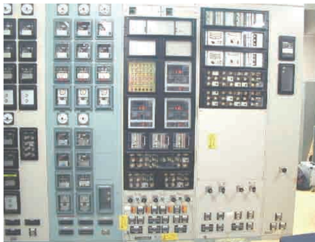
発電所内の保護継電器装置
